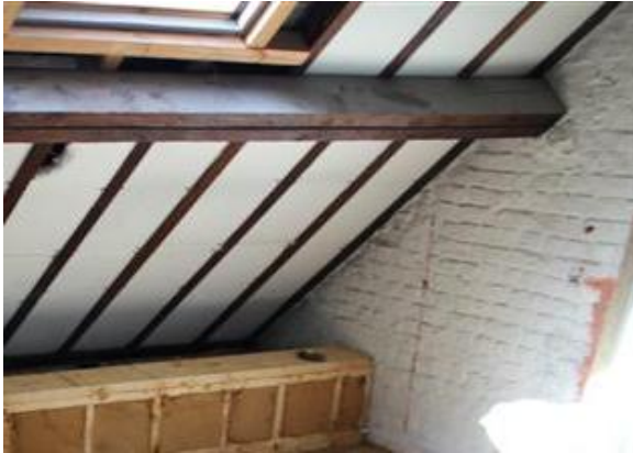
Photo 11 – Pannes de toiture (Source : Alexandre O., 2011)
