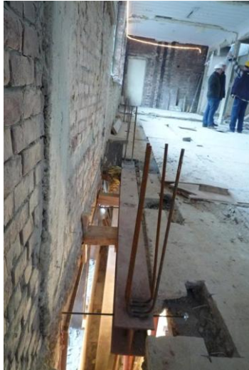
Photo 47 - Encoche dans la dalle en béton (Source : Bureau A2M, 2011)
