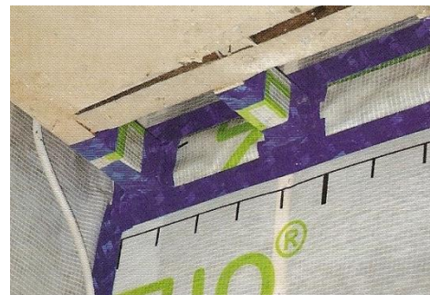
Photo 7 - Gîtage emballé par le freine-vapeur (Source : Bureau FHW, 2007)
