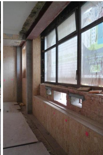
Photo 51 - Exécution des caissons en OSB remplis d'isolant en cellulose (Source : Bureau A2M, 2011)
