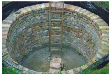
Figure 28: Citerne en maçonnerie (source : Deltau, 2004)
