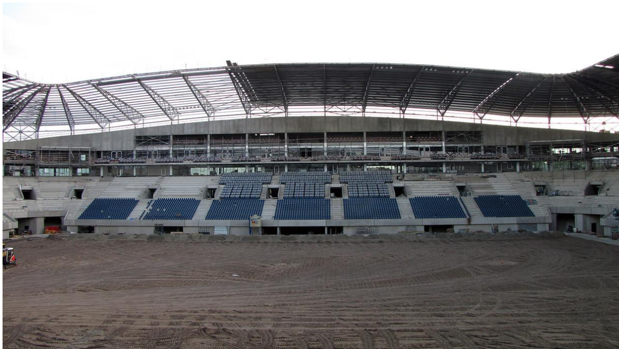
Figure 19 : Photo du 29 juin 2013, lors de la pose de la couverture en aluminium de la toiture ondulée, sur le chantier. Photographie : Pieter Vantieghem (source : http://www.ourfuturestartshere.be/pictures , 2013)
