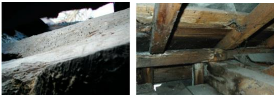
Figure 136 – Dégradations de la charpente (CSTC, 2010)
