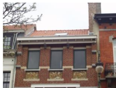
Figure 59 - Vue de la toiture depuis la rue (Marc Van der Stricht Architecte, 2010)
