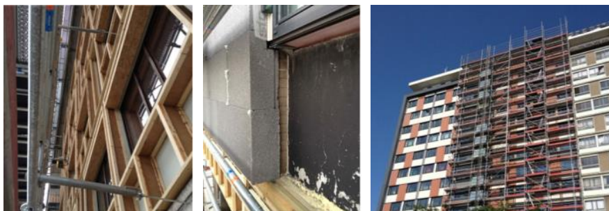
Figure 89 - (a) Nouvelle peau extérieure en caisson de bois - (b) Isolation des petites façades - (c) Façade en cours de rénovation (AW Architectes, 2013)
