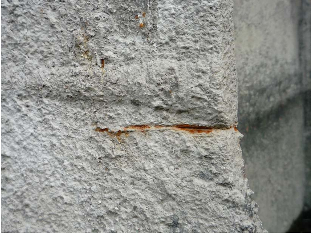
FIGURE 4.9 – Amorce de fissure sur le vantail gauche
