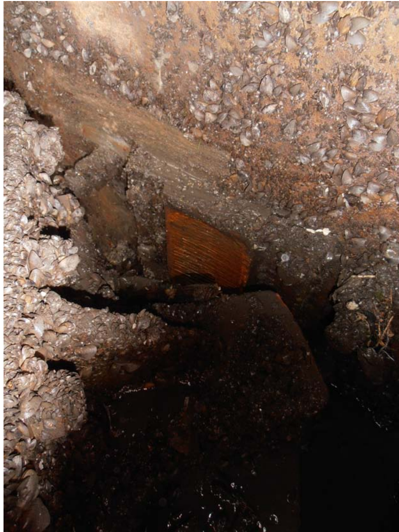
FIGURE 4.8 – Usure importante d’un heurtoir à l’amont [Vercruysse]
