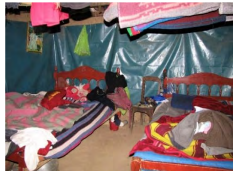
Figure 181 : Chambre à coucher (indiquée sur le plan par le chiffre 4) à droite : lit des parents ; à gauche : lit des enfants Le plastique vert collé au mur a pour but de se protéger des chutes de particules résultant de l'effritement des murs.
