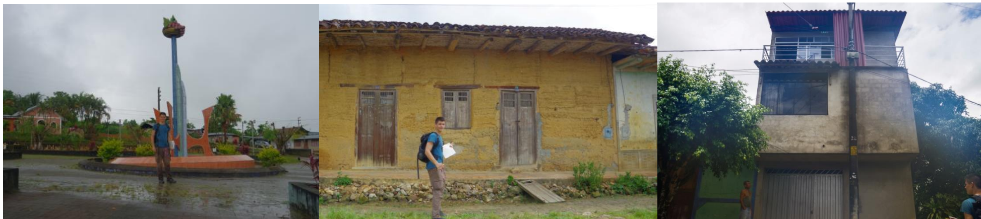
▲ Ci-dessus, de gauche à droite : Place publique de San Antonio ; bâtiment en tapial détérioré par les pluies ; bâtiment de type 6.c. au cœur du village. Crédits photos : Pierre LEGNIERE
