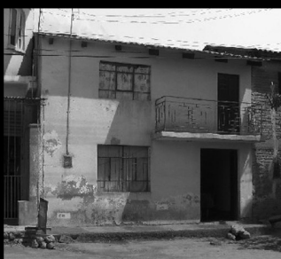
Figure 2 : Balcon en porte-à-faux
