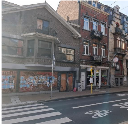
Figure 5-132 : Photographie de dégradations présentes sur les bâtiments de la rue Rogier, C. Collin, le 5 décembre 2025.
