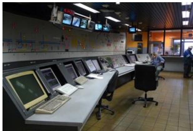
Figure 3.20 – Intérieur du poste de commande (© V. Duseigne & S. De Wilde, 2009)
