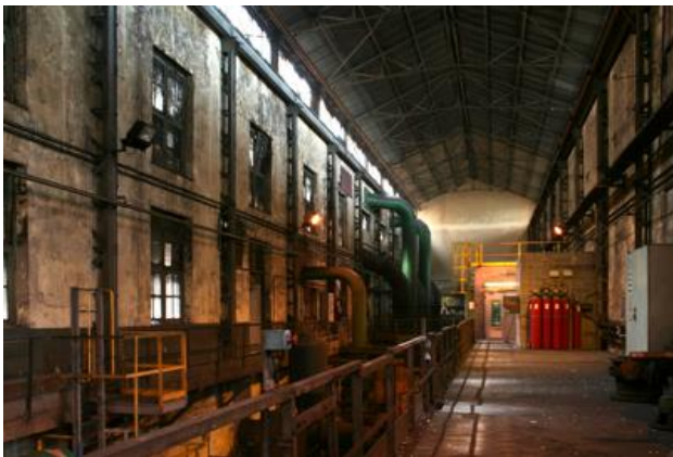
Figure 3.28 – Intérieur du bâtiment pompe Meuse (© V. Duseigne & S. De Wilde, 2009)
