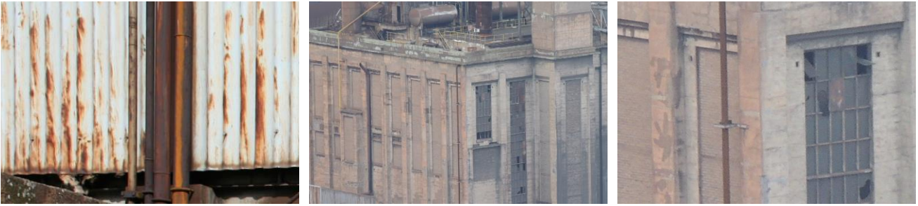
Figure 8.24 – 1 détail des façades du hall énergie (à gauche) et 2 détails de celles du bâtiment chaudières (à droite) (© V. Duseigne & S. De Wilde, 2009 & photos de l’auteur, 2017)
