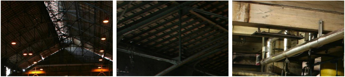
Figure 8.21 – 2 détails de la structure portante du hall énergie (à gauche) et 1 détail du bâtiment chaudières (à droite) (© V. Duseigne & S. De Wilde, 2009)
