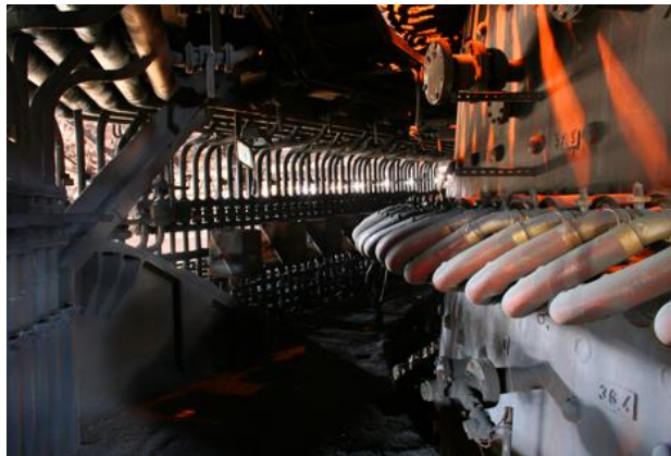
Figure 3.12 – Refroidissement du HF B (© V. Duseigne & S. De Wilde, 2009)
