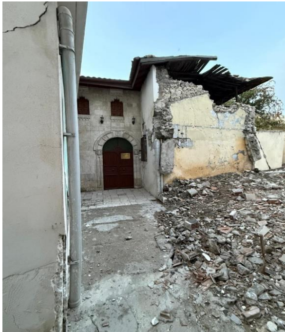
Figure 82. État de la Maison de Saint Luc à Antakya après le séisme du 6 février 2023, révélant une destruction partielle du bâti, l'effondrement des planchers et la mise à nu des structures en maçonnerie. @SemihMentese
