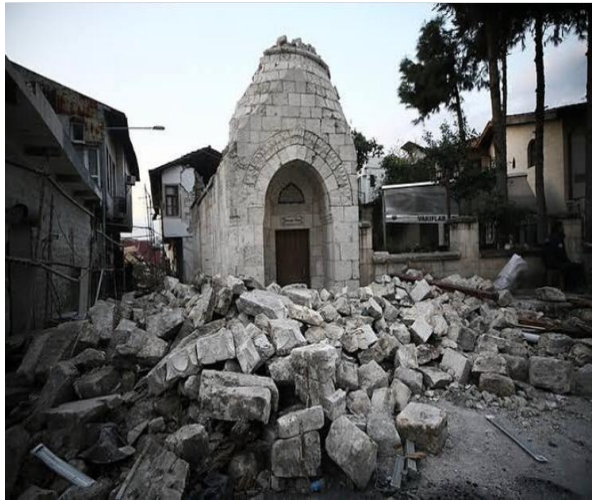
Figure 80. État du minaret de la mosquée Sarimiye à Antakya après le séisme du 6 février 2023, révélant la résistance partielle de cet élément vertical face à l'effondrement généralisé du bâti environnant. @Korhan
