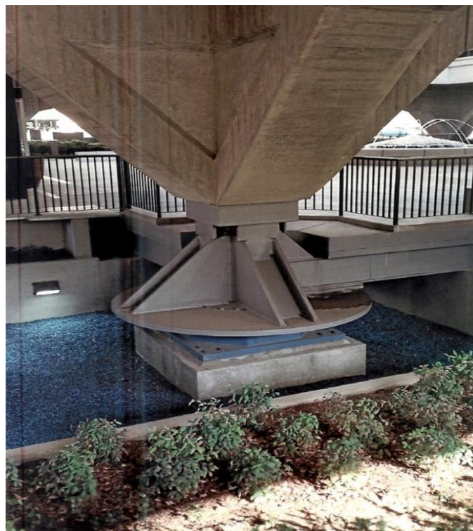
Figure 17. Isolateur sismique installé sous un bâtiment public. @Wikimedia
