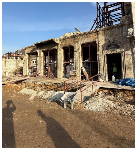
Figure 69. Café Affan en cours de restauration après le séisme, Antakya. @SemihMentese
