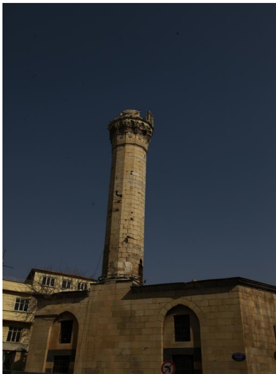
Figure 120. Mosquée Karagöz endommagée après le séisme à Gaziantep. @Tarihistan
