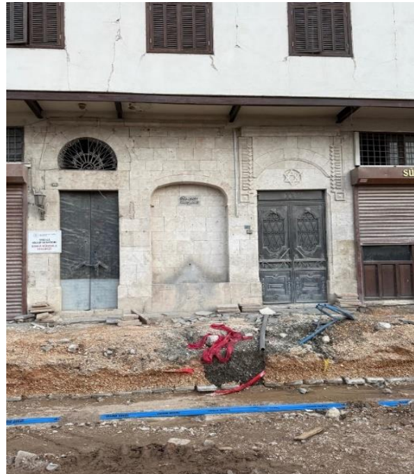
Figure 83. État de la synagogue juive d'Antakya après le séisme du 6 février 2023, révélant des dommages modérés sur la façade en maçonnerie ainsi que les transformations du sol liées aux travaux de reconstruction sur Kurtuluş Caddesi. @SemihMentese
