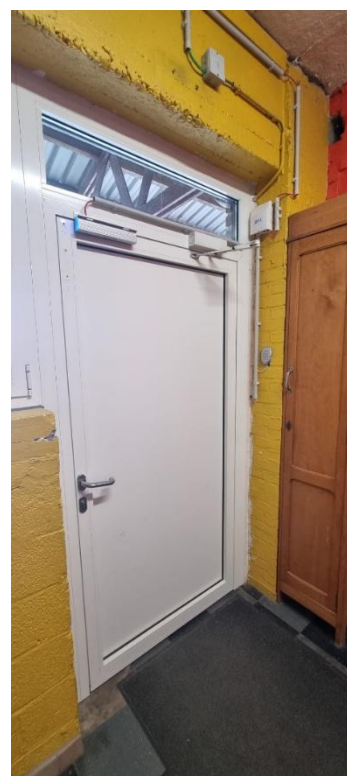
Système de fermeture des portes à codes
