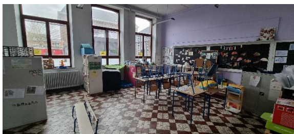
Classe avec les problèmes acoustiques
