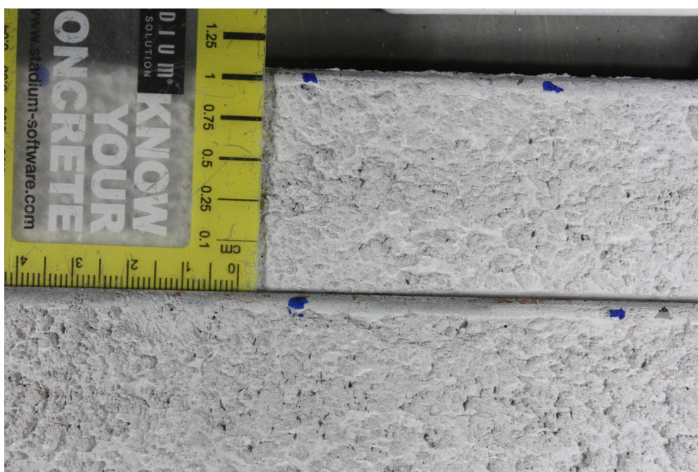
FIGURE 183 – Fissuration observée à l'oeil nu pour le mélange RS1 K+SRA (après 60j)
