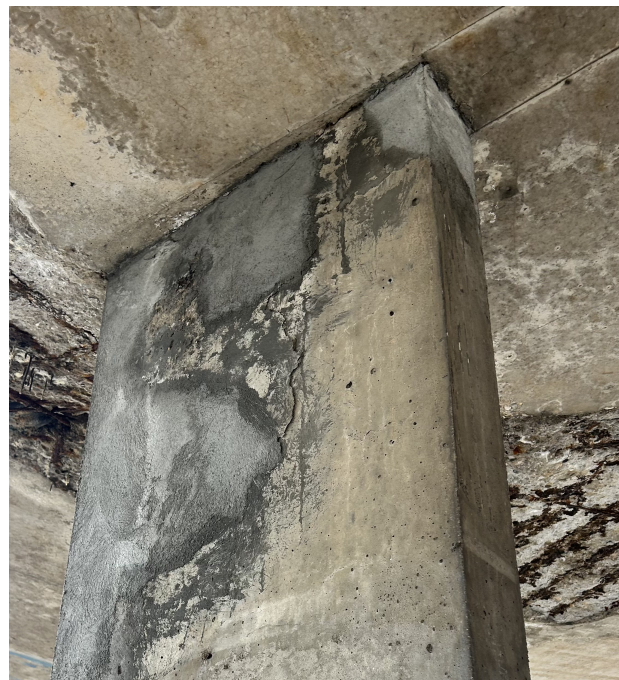
FIGURE 16 – Décollement du mortier de réparation passerelle Saucy Liège (photo personnelle)
