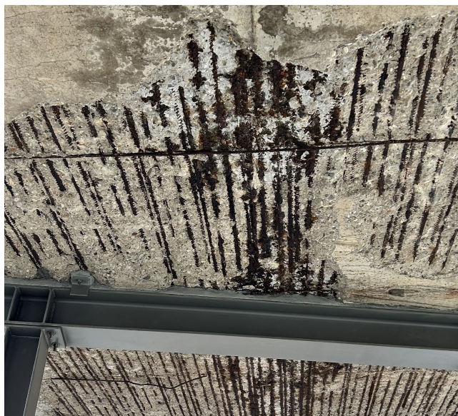
FIGURE 14 – Ouvrage béton dégradé : passerelle Saucy, Liège (photo personnelle)
