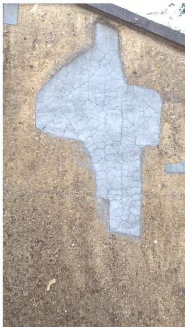
FIGURE 15 – Fissuration du mortier de réparation (Courard, 2025)
