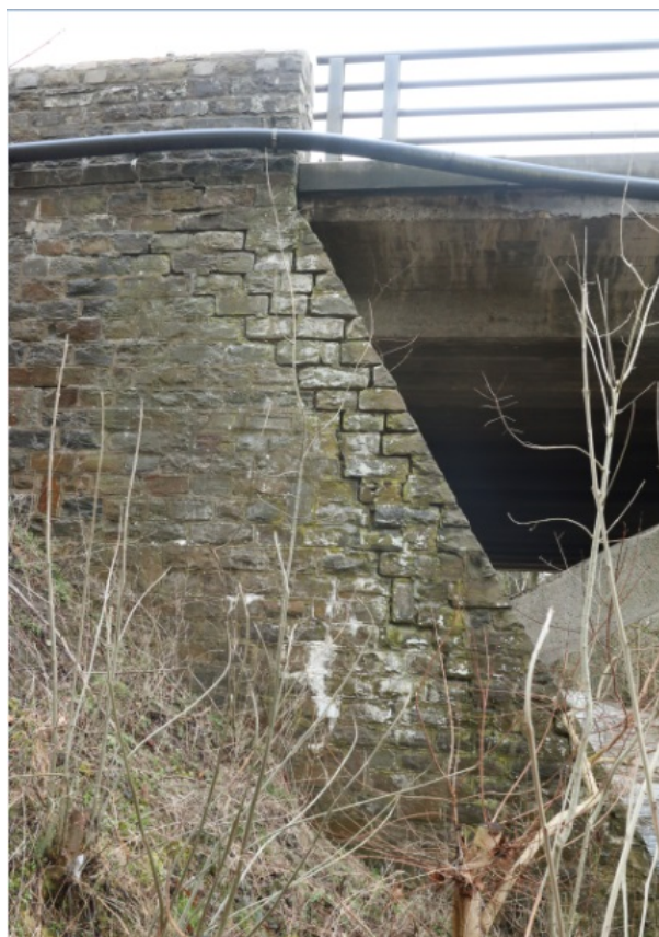
FIGURE 2.10 – Etat de la maçonnerie à l'encastrement de l'arc
