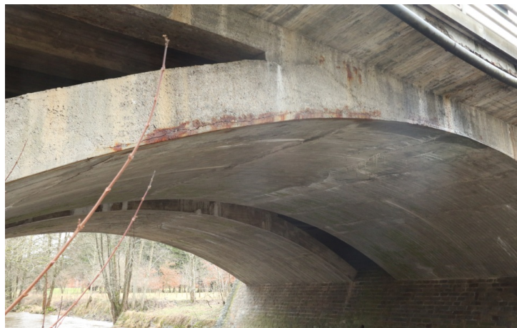
FIGURE 2.8 – Corrosion des armatures à l'intrados de l'arc et coulées blanchâtres
