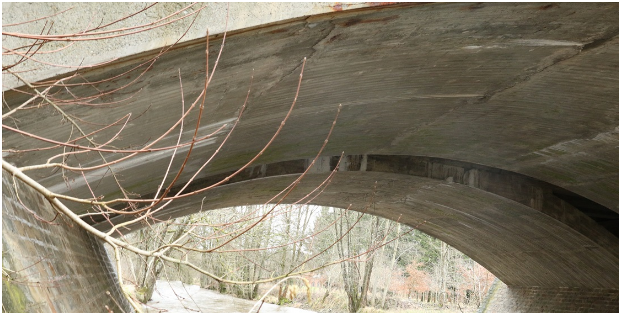
FIGURE 1.2 – Photo de la fissure en sommet d'arc
