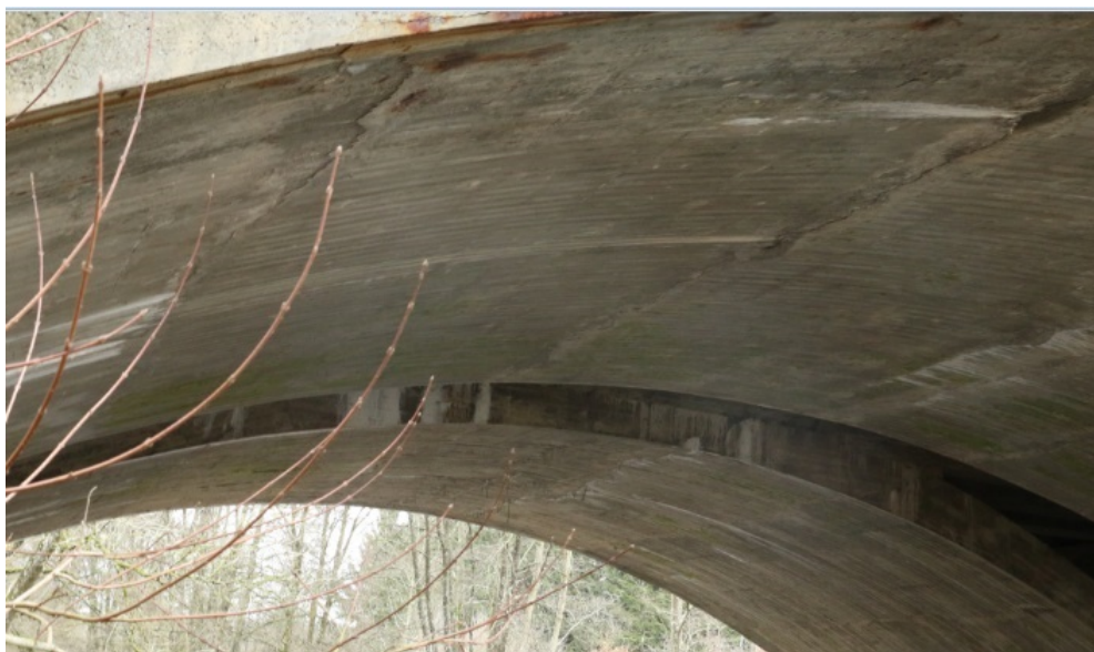
FIGURE 2.9 – Grosse fissure à l'intrados de la clé d'arc
