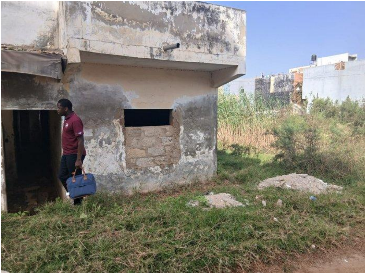
Photo 2 : Habitation abandonnée par ses occupants dans le quartier UCAD I à Keur Massar Sud, suite aux inondations récurrentes. (Cliché : DIALLO M.Y., terrain 2026)
