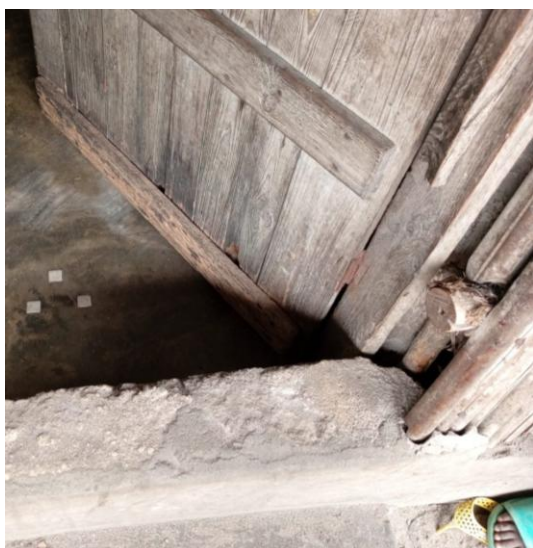
Figure 13 : Photo d'entrée de porte rehaussée en ciment pour limiter les entrées d'eau dans l'habitation (cliché : E. OUEDRAOGO, 2026)
