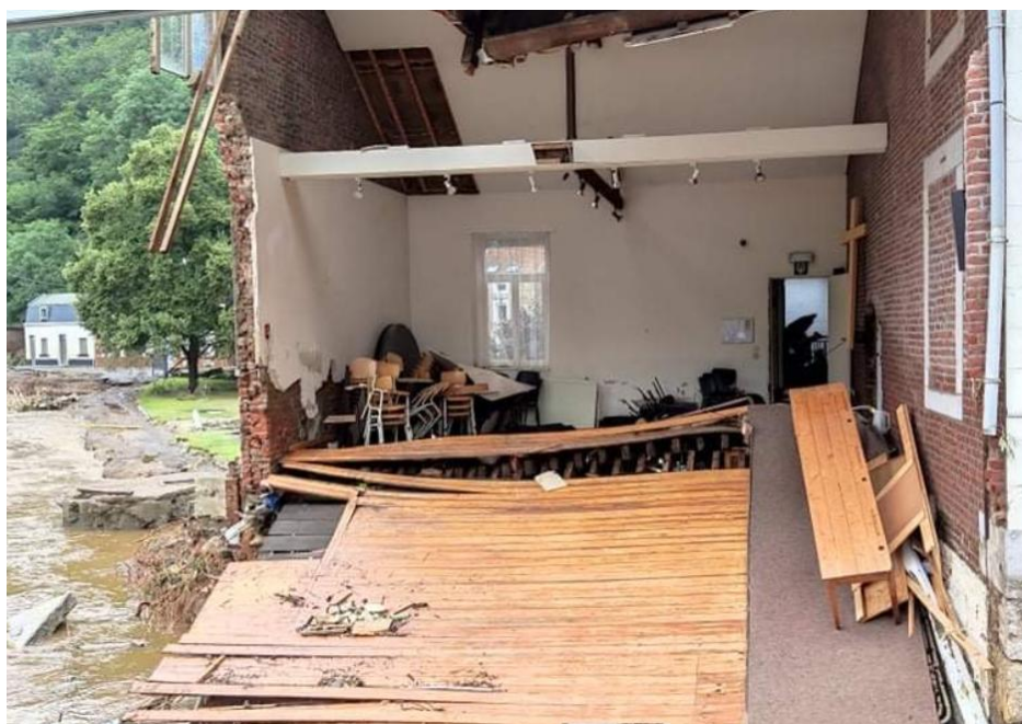
Figure15. Dégâts causés par les inondations de juillet 2021 à Nessonvaux, (photographie prise par un riverain)
