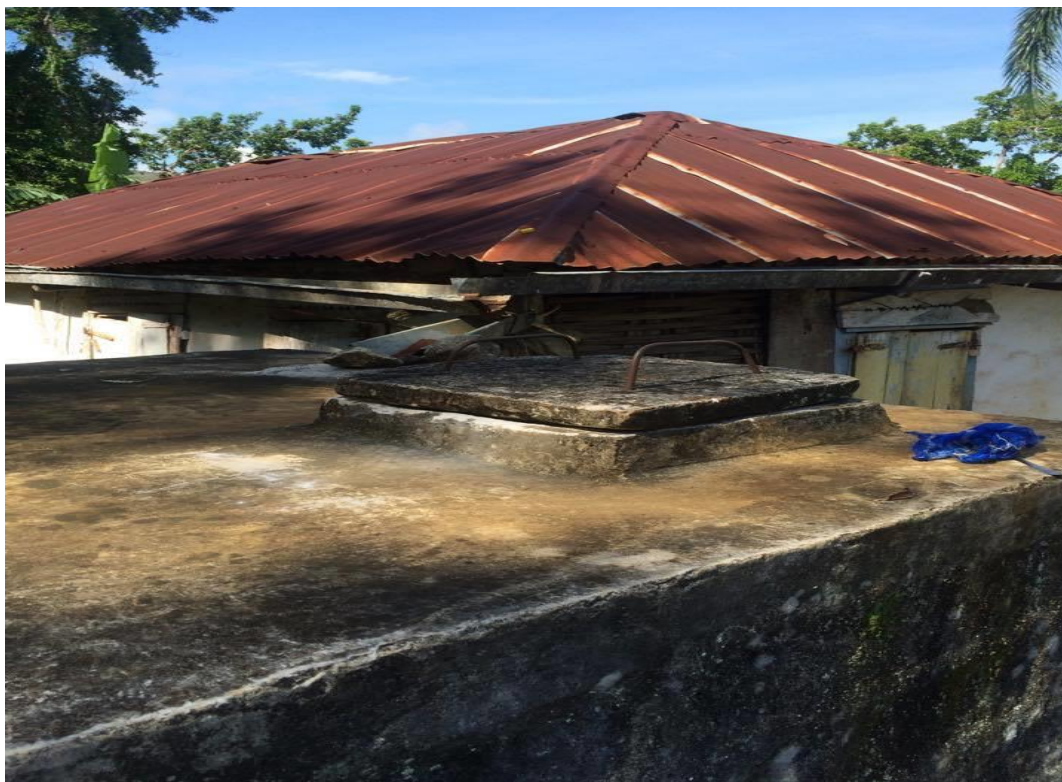
Figure 14. Vue de l'état d'une citerne et de la toiture de l'habitat (Orélien, 2017).
