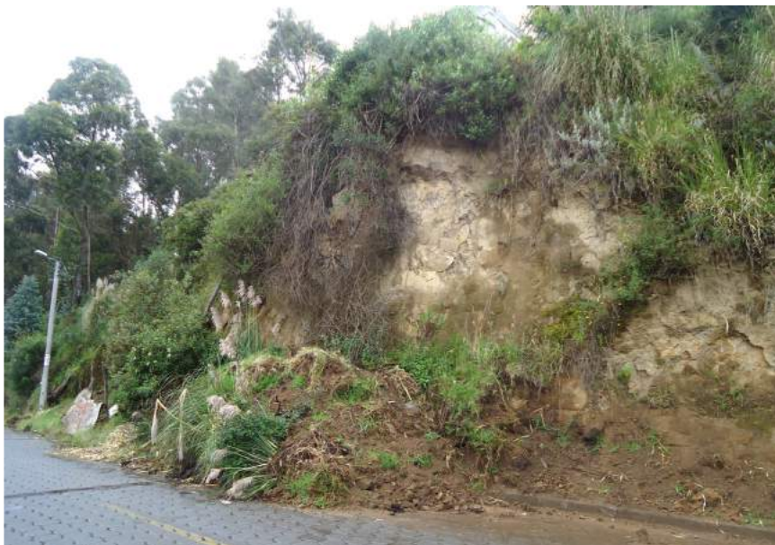
Illustration 59 – Glissement d'un talus sur la route
