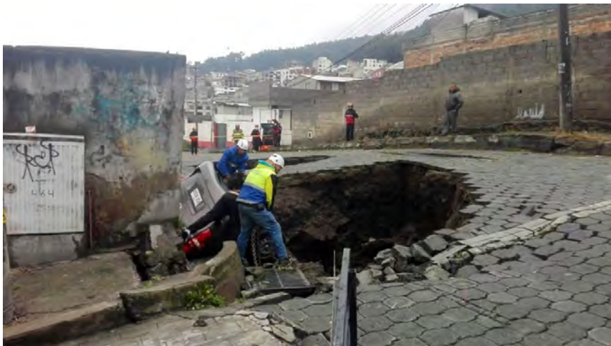
Illustration 42 – Effondrement de la rue d'Ana Maria Bajo (1)
