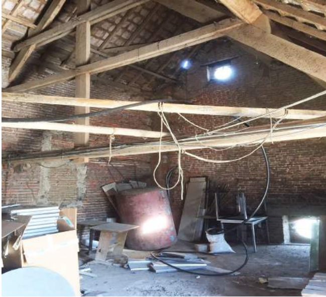
Fenil dans la première partie
