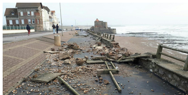
Figure 1.10. L'érosion varie dans le temps et l'espace en fonction de l'action effectuée. Impacts paysagers causés par la destruction de digue à Ambleteuse. 2018
