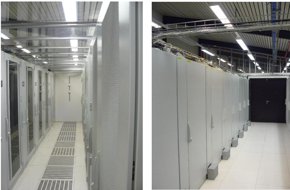
Figure 20 - Allée froide (gauche) et chaude (droite) du SEGI.
