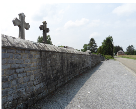
Figure 49: Mur coté rue cache la mort inacceptable
