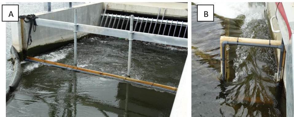
Figure 11: Illustrations des antennes RFID installées en amont de deux voies de passage du barrage de Méry. A) Antenne en amont de la vis d'Archimède – B) Antenne au niveau de la nouvelle échancrure.
