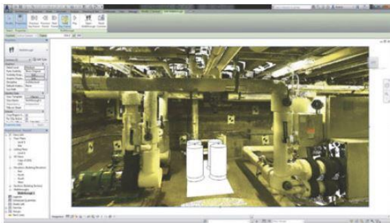
Figure 15. Visualisation du projet inséré dans l'existant (modèle + nuage de points) (Source : LandTech).
