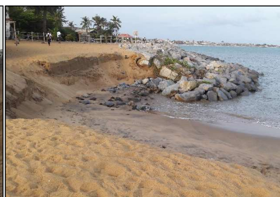
Photo 1 : Déchaussement progressif du revêtement d'El Dorado (cliché Assogba, 2018).
