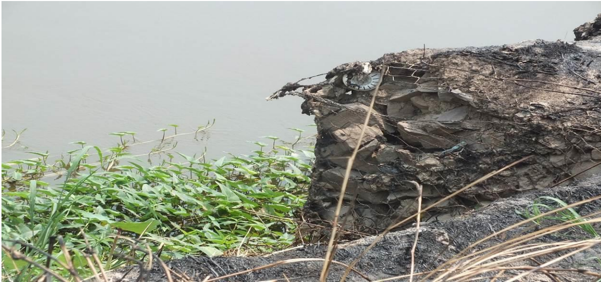
Figure 15 : Eroulement de la digue sur les berges de la rivière N'djili
