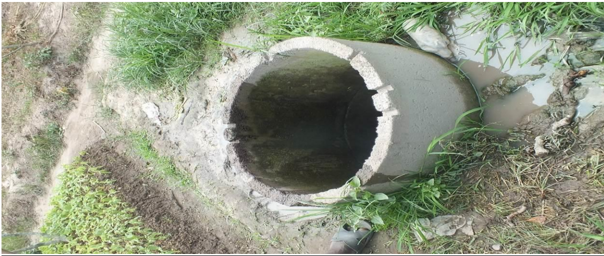
Figure 10 : Puits à buse plus haut que la surface du sol
