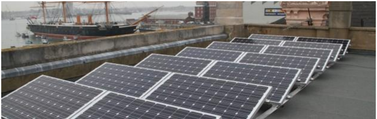
Figure 24 : Panneaux solaires photovoltaïques placés sur un toit de manière non visible, dissimulés par des parapets (Solar Voltaics, 2012)
