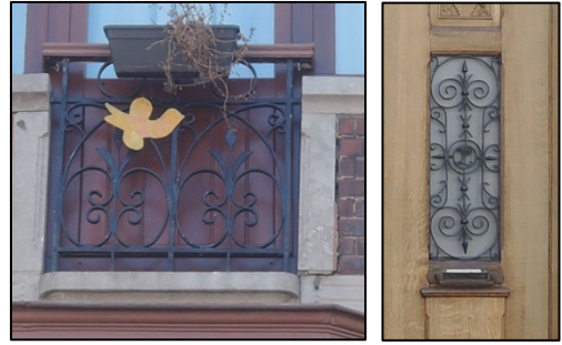
Ci-dessus, les ferronneries présentes au deuxième étage (à gauche) et sur la porte, à droite)
