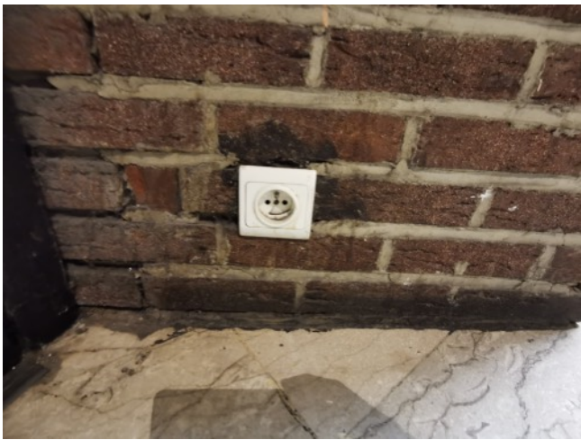
fig 6 : Il existe deux sources d'alimentations électriques dans l'espace occupé par les danseurs.
