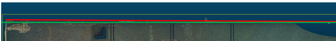
Figure 50 Problème d'inclinaison d'un mur d'Office_4. La ligne verte est une ligne parallèle à l'axe X et provenant du second coin du mur. La ligne rouge représente le plan vertical du mur. (Vue du haut)
