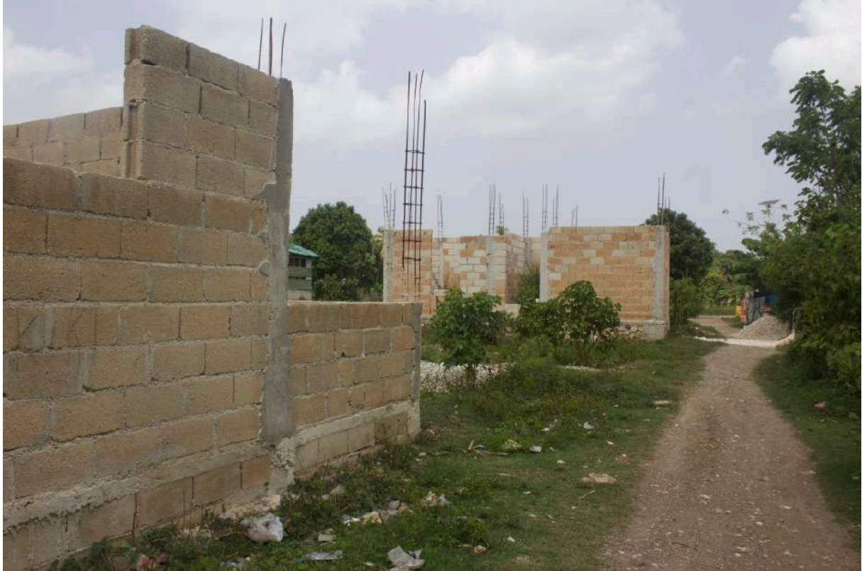
Photographie 15 : Construction en béton inachevée par manque de moyens. Photographie prise par M. Thomas le 9 août 2018 à Modsol.
