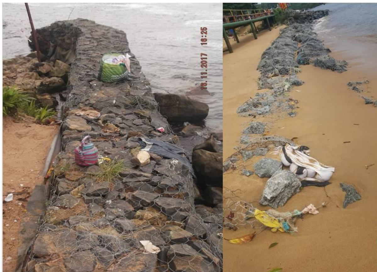
Planche photo 11 : Digue de protection des chutes de la Lobé en pleine ruine (cliché : Mbevo 2017)
