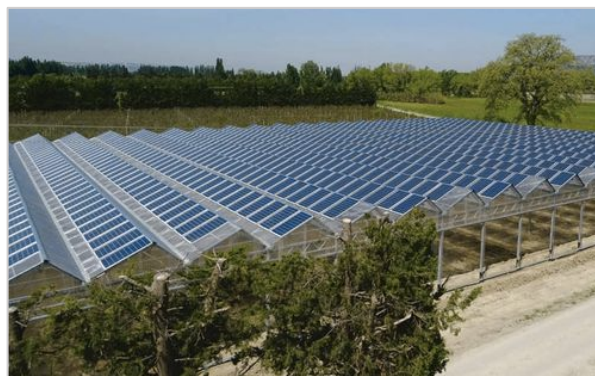
Figure 9 Système intégré de panneaux photovoltaïque et mise en culture de la parcelle 15
