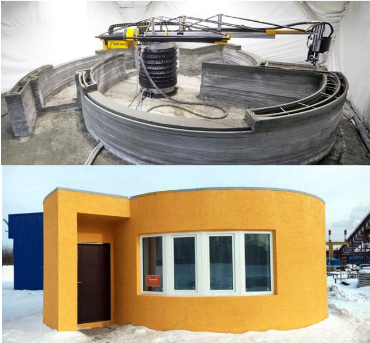
Figure 8 : Habitat imprimé par l'entreprise Apis Cor en Russie. En haut pendant le chantier, en bas lors de la livraison.
