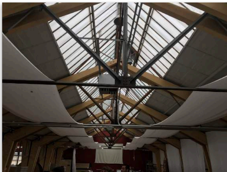
Photo d'un espace évènementiel rénové appartenant à M. Daou sur le site des ACEC à Herstal, exprime aussi un potentiel de transformation.
