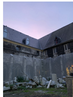
Fig. 55 - Stockage des matériaux dans la cour du cloître de la cathédrale, 2019 de robots-tailleurs, 2019
