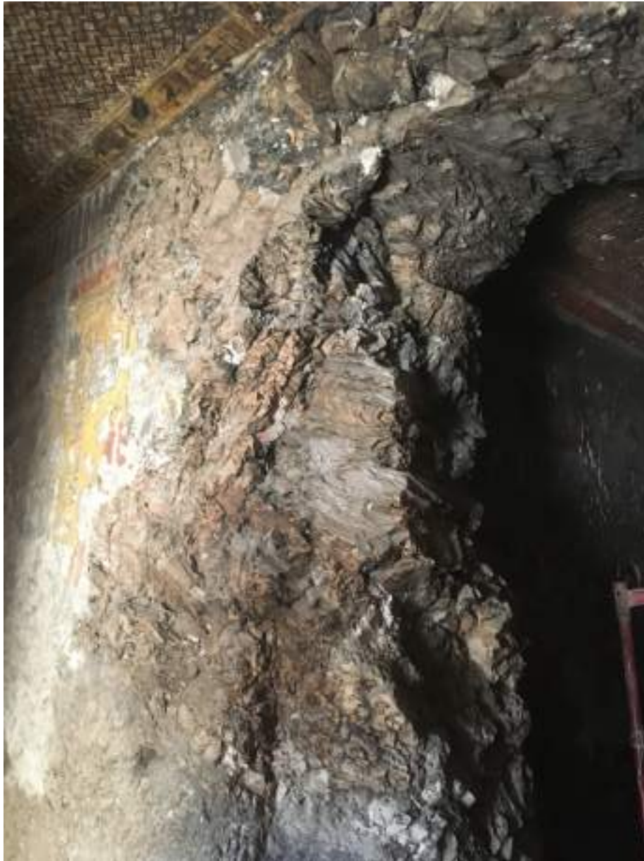
FIGURE 7.4 – Entrée de la salle longitudinale très détériorée.
